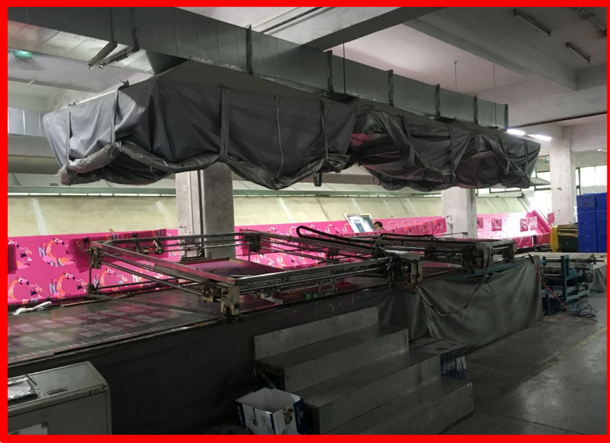
Kaynağın etrafı çevrilmemiş
